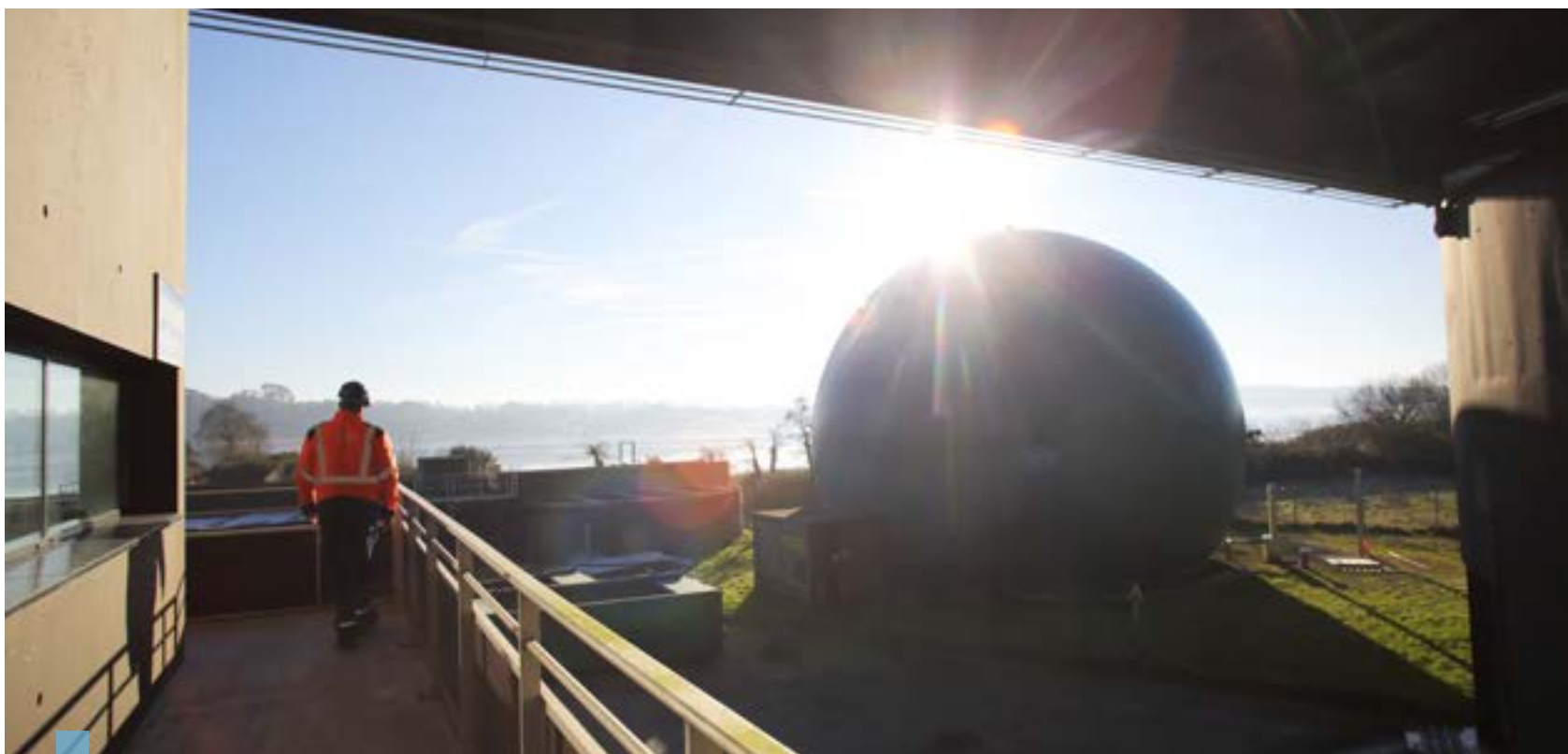
La station d'épuration du Corniguel est le vaisseau amiral de l'Agglomération pour le traitement des eaux usées. Elle produit également du biogaz. Ici le digesteur.
